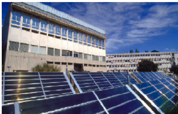
Fourniture d'eau chaude dans un centre médical grâce à l'énergie solaire thermique.
