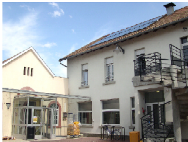
Chauffe-eau solaire collectif installé dans une cantine municipale permettant la fourniture d'eau chaude.
