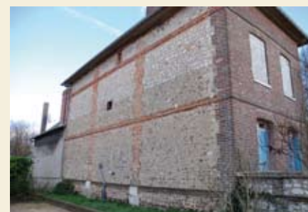
Un habitat « bioclimatique » : bâtiment tampon au nord-est, pas d'ouvertures au nord-ouest, toutes les fenêtres au sud.
