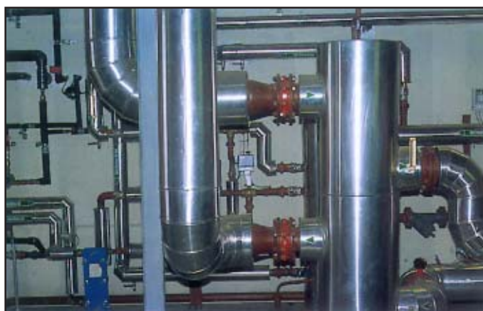
Chaufferie au bois au lycée agricole de Chambray.
